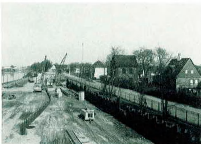
Blick vom Pumpenhaus auf den Pumpwerkskanal
