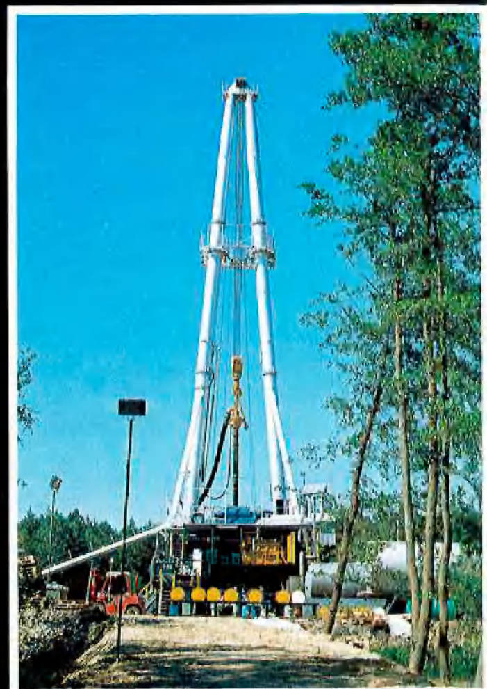
Mit einer schweren Tiefbohranlage wurde das Bohrioch mit einer Abweichung von nur ca. 14 cm von der Vertikalen fertiggestellt.
