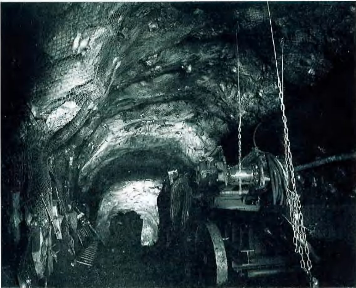
Abb. 5: Vorortbereich während des Wegladens des Haufwerks: linke Bildseite: Kohlen- stoßverankerung mit Holzplatten
