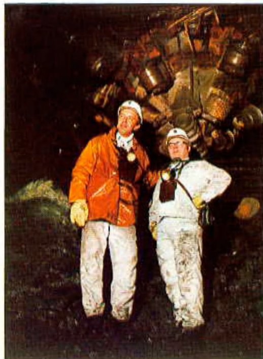
Abb. 5: Geschäftsführer K. H. Brummer beglückwünscht den Deilmann-Haniel-Betriebsstellenleiter K. Unterste zum erfolgreichen Durchschlag des Blindschachtes
