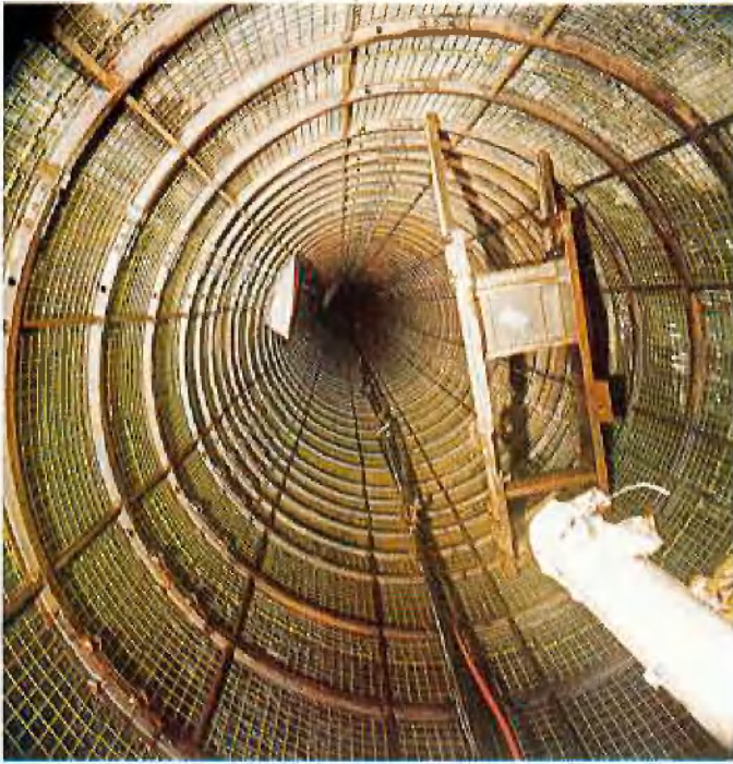
Abb. 3: Blick von der Gesenkbohrmaschine aus nach oben in den fertiggestellten und ausgebauten Blindschacht von rd. 6 m lichtigem Durchmesser
