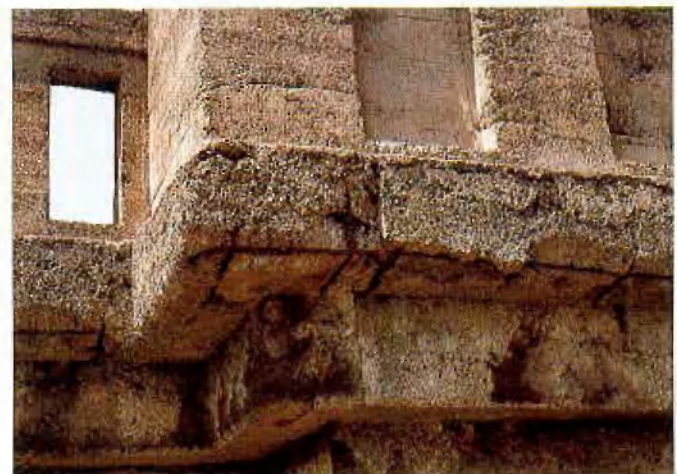
Abb. 4: Korrosion der Bewehrung wegen fehlender Betondeckung an den Brüstungen
