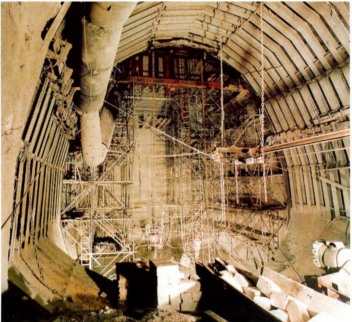
Abb. 11: Blick in die Schachtunterfahung Grimberg 2 auf der 960-m-Sohle mit Dellmann-Haniel Schachtglocke und Polygonringausbau während des Hinterfüllvorganges mit Beton und Hinterlegung mit Ytongsteinen
