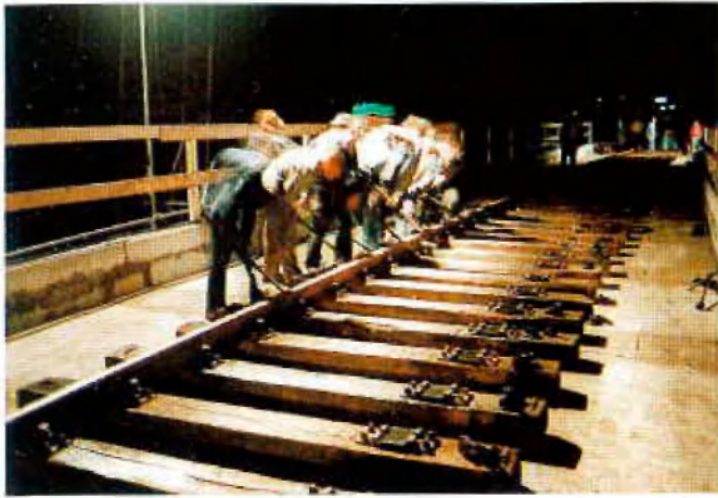
Abb. 15: Vorbau des Gleises in der Nacht (Für die Bauzeit lagen die Holzschwellen unmittelbar auf den Fertigteilplatten).
