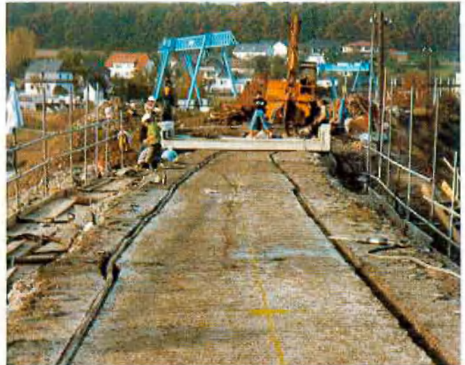
Abb. 9: Vorbereitetes Gewölbeplanum zum Auflegen der Fertigteile; Ausgleichbeton mit Rinnen für die Mörtelpumpschläuche und mit Markierungen für das Ausrichten der Fertigteile
