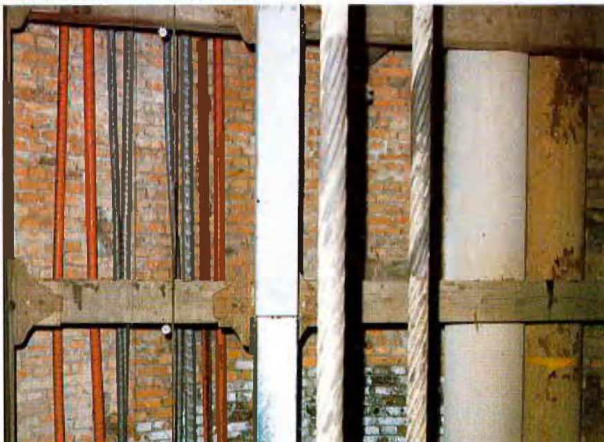
Abb. 10: Frei im Schacht hängender Stahlsperlattenstrang
