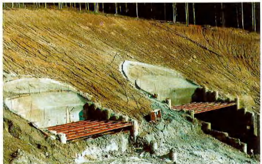
Abb. 14: Fertig eingebaute Portalsicherung
