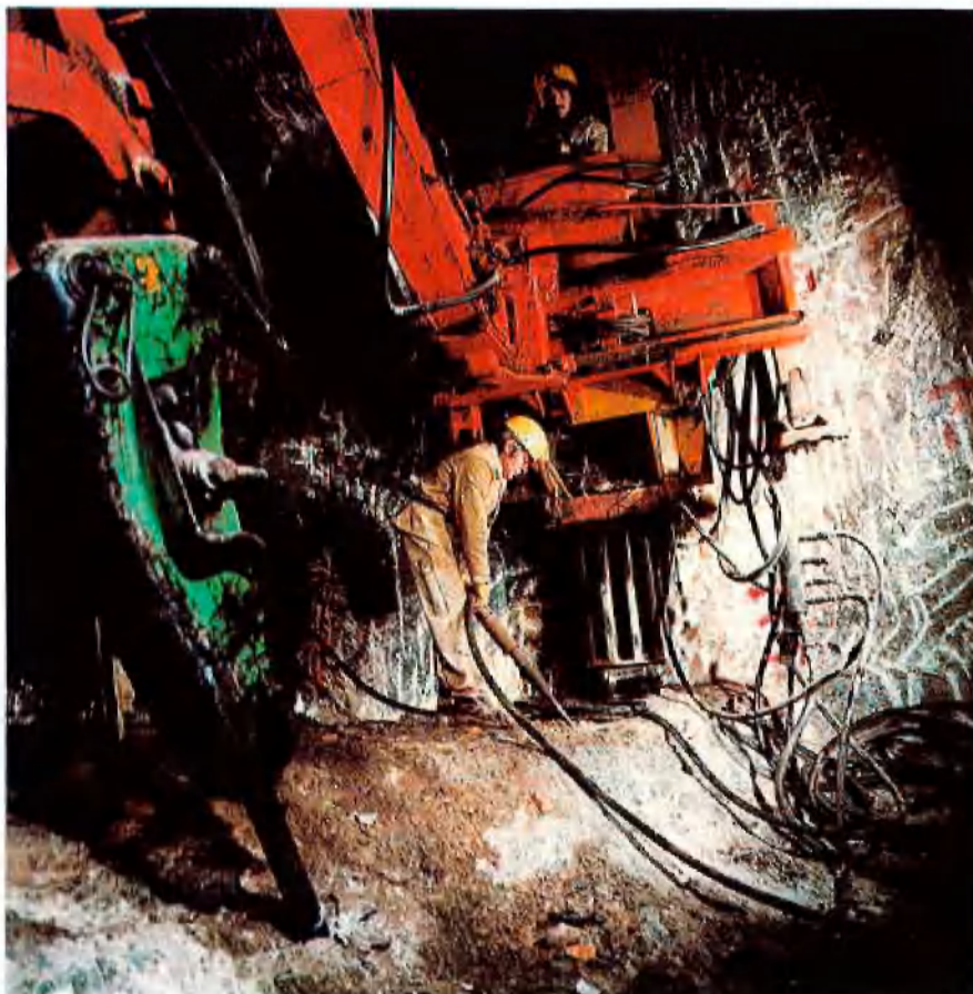
Hydraulikhammereinrichtung im Wetterschacht Riedel
