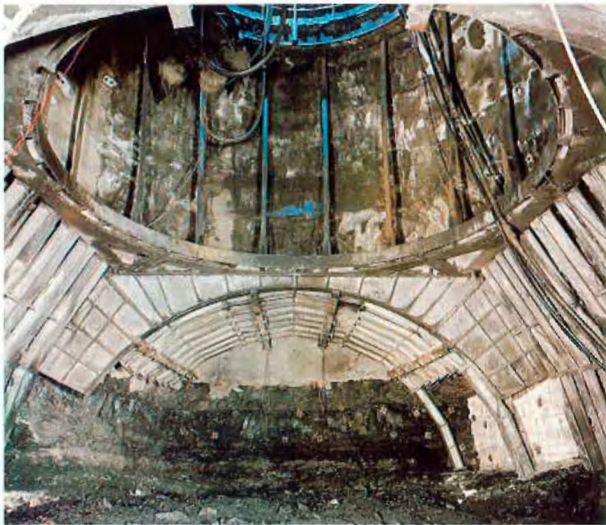
Abb. 5: Blick vom Schachtquerschnitt in den westlichen Füllortansatz beim Herstellen der Scheibe 4. Im südlichen Streckenstoß gesetzte Ytong-Mauerung beim Durchgang des Flözes Zollverein 7/8 (Zeichnung 5)
