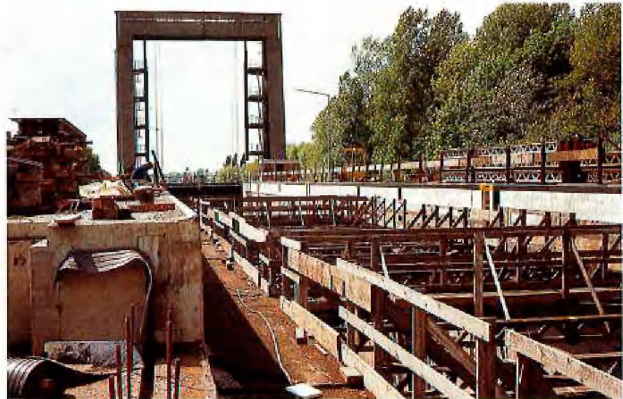
Schleuse Wanne-Eickel: Aufhöhung des Drempels im Oberhaupt bei verschobenem Klapptor
