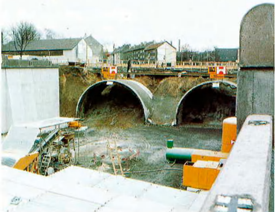
Abb. 2: Anschlagsituation am Nordportal
