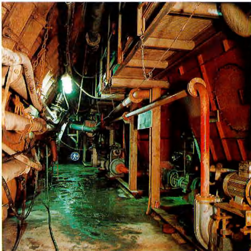
Bergeentwässerung und Wasseraufbereitungsanlage am Anschlag
