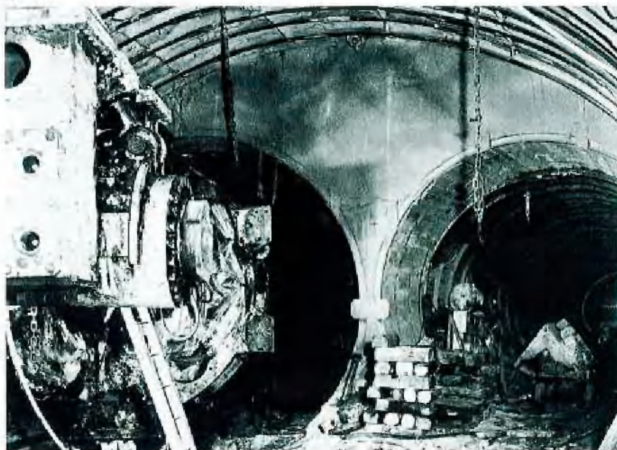
Abb. 5: Umbau der SVM für den dritten Bauabschnitt vom Bohrdurchmesser 4,80 m auf 5,10 m
