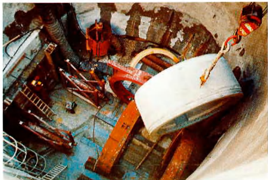
Abb. 4: Preßstation im Zentralschacht
