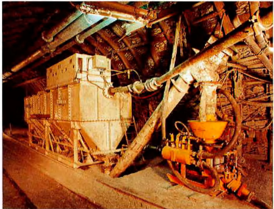
Abb. 3: Betoniereinrichtung mit Vorratsbunker
