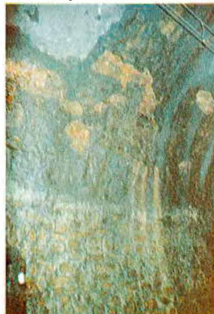
Abb. 2: Die stark durchfeuchtete Tunnelleibung
