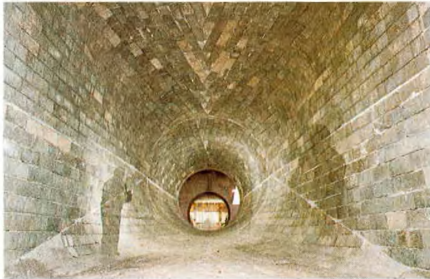
Lüfterkanal mit schalldämmender Mauerung
