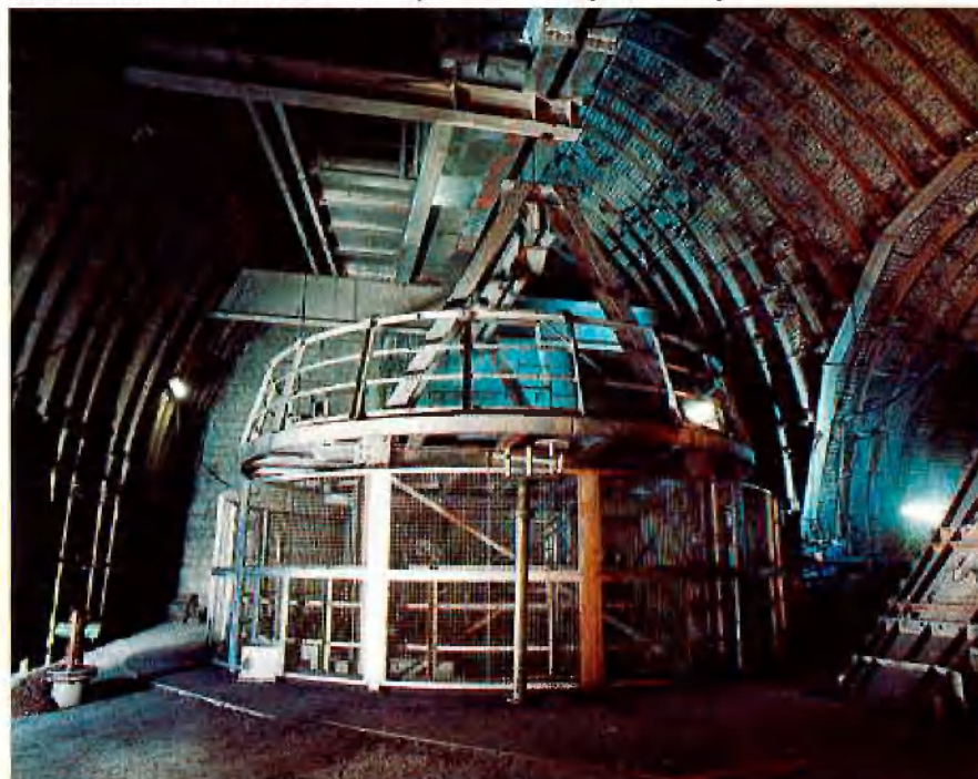
Schachtbunker Haus Aden; Bunkerkopf mit Befahrungseinrichtung
