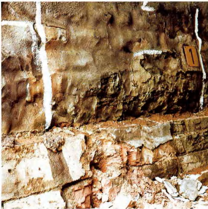
Abb. 2: Zerstörungserscheinungen am Widerlagermauerwerk
