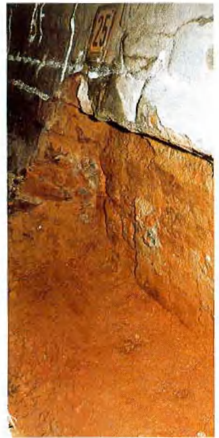
Abb. 3: Ausgebrochene Lamelle im Widerlagermauerwerk
