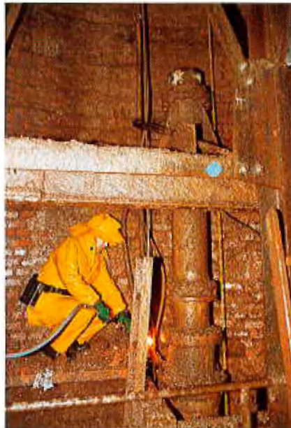
Abb. 4: Ausbrennen von Bohrleitungen und Verlagerungen
