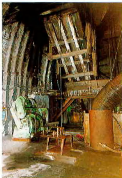
Abb. 7: Kippbunker mit Notfahrtwinde
