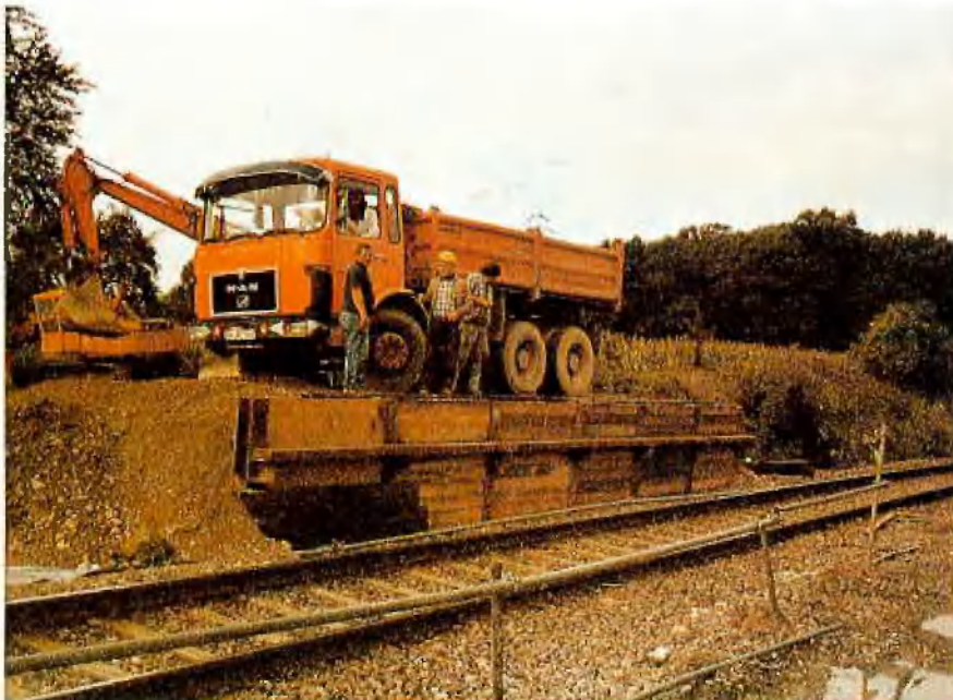
Abb. 9: Behelfsladerampe auf freier Strecke
