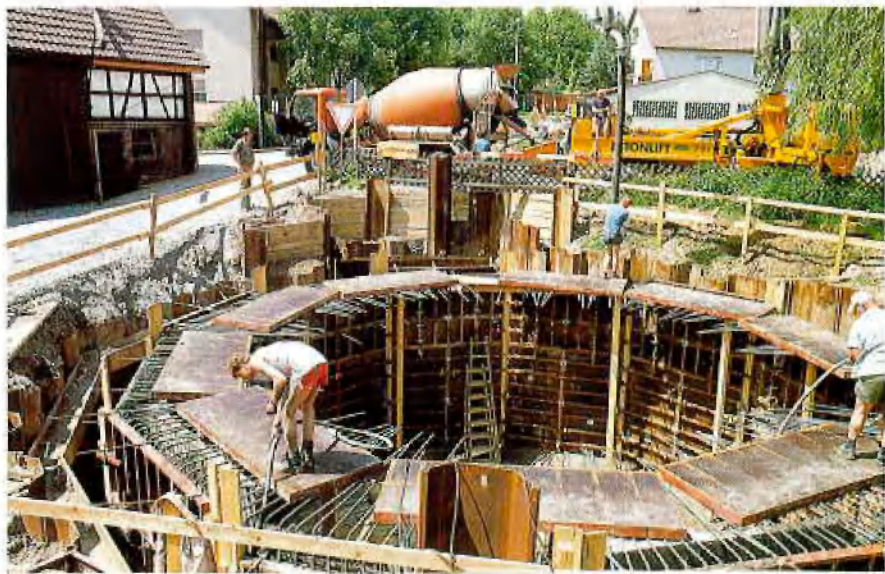
Regenüberlaufbecken in Ditzingen
