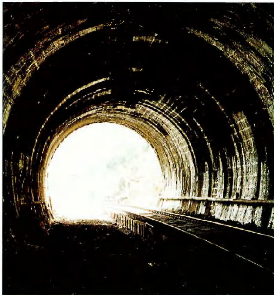
Abb. 1: Vollkommen durchnäßtes Tunnelmauerwerk im Portalbereich
