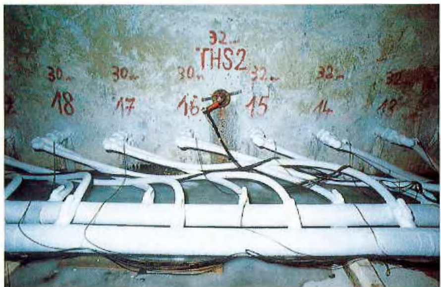
Abb. 11: Vereisung an der Stationswand
