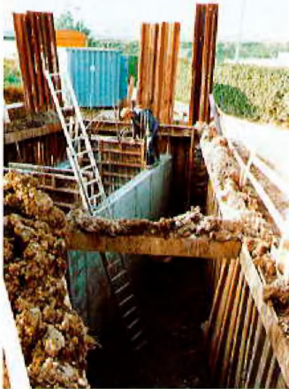
Meß- und Steuerschächte Möglingen
