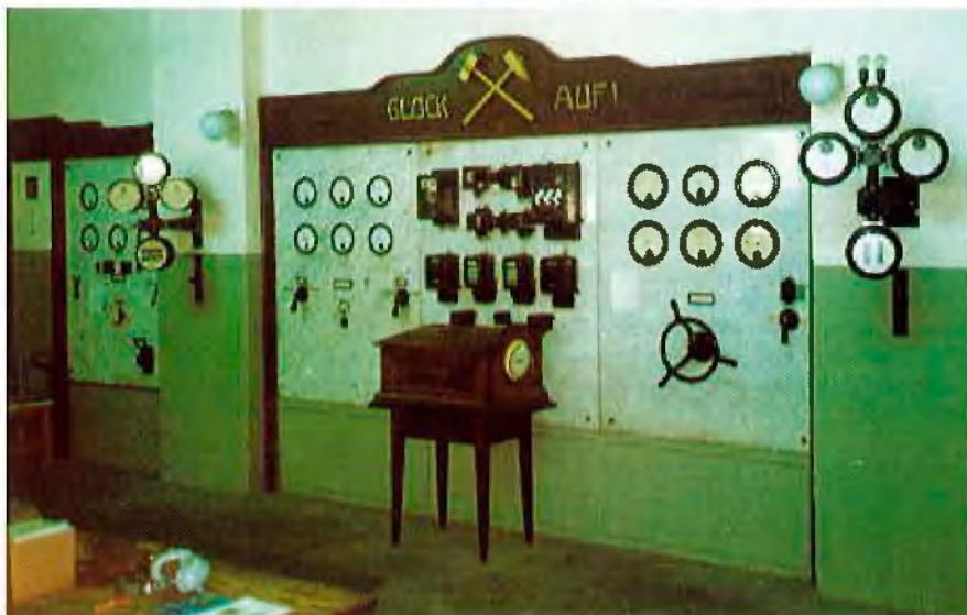
Abb. 9: 1911 errichtete Schaltzentrale in der Oberstufe des Kraftwerkes in Oberried.
