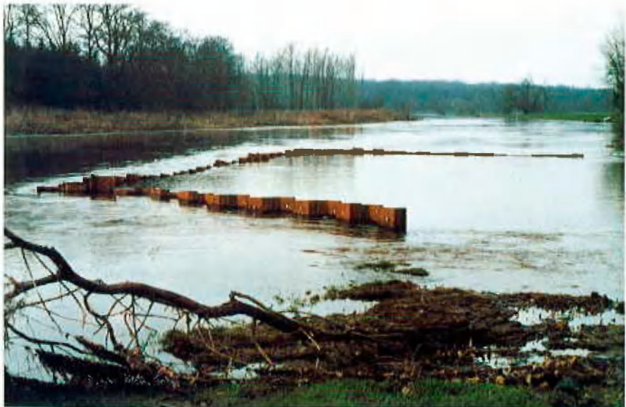
Spundwand KWL, Überflutung der Baustelle
