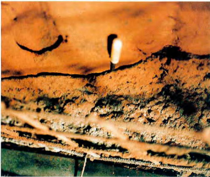
Abb. 5: Spaltbildung in der Firste zwischen Spritzbeton und Sandstein
