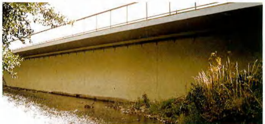
Kragarm der Stützwand - Detail vor der Instandsetzung
