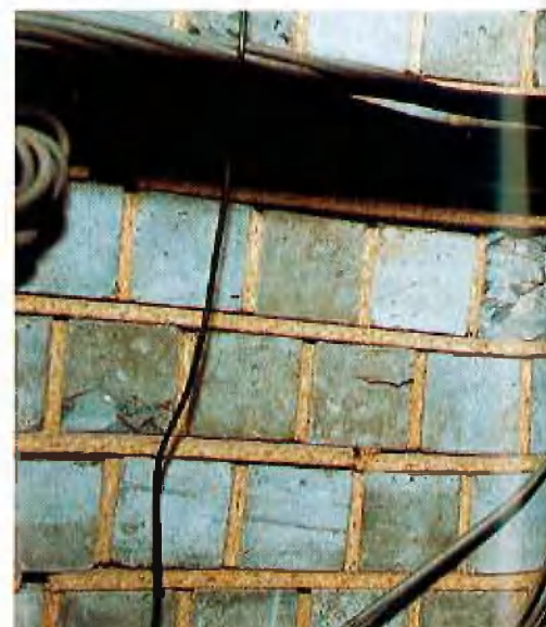
Abb. 5: Erste Beschädigungen am Ausbaumodell
