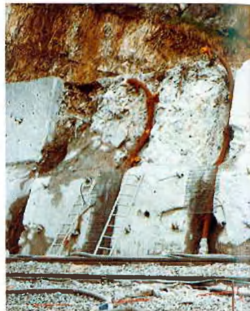
Vertikale Drainageschleife mit Entwässerungssystem
