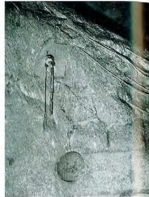
Abb. 4: Schäden an der Wendel
