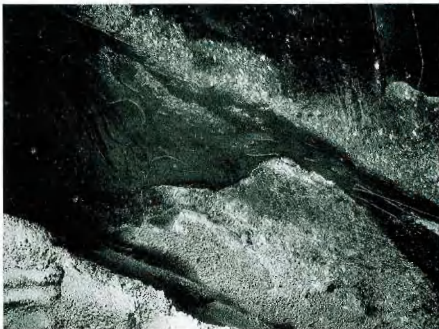
Abb. 5: Schäden im Bunkerauslauf
