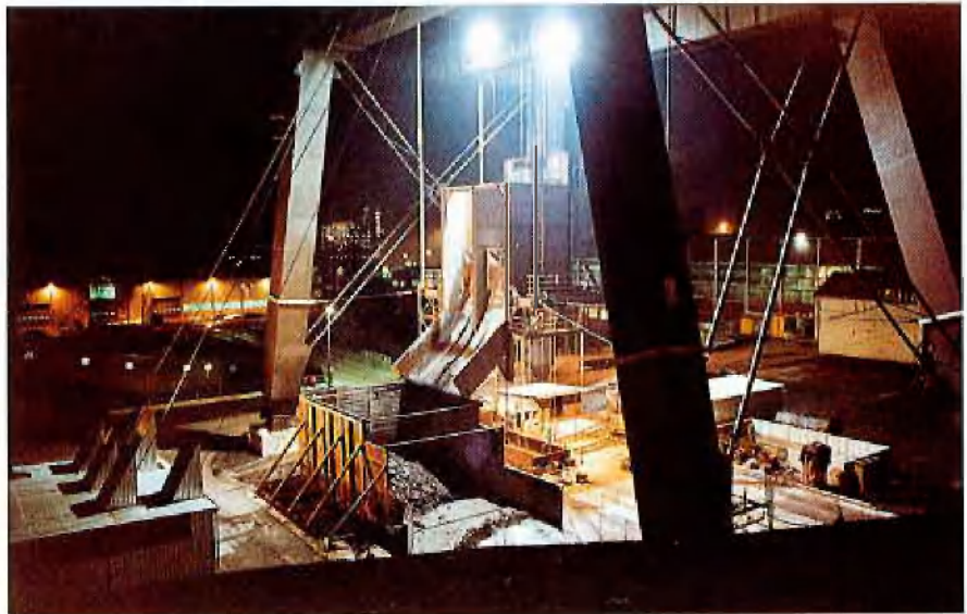
Fördergerüst mit Kippbühne
