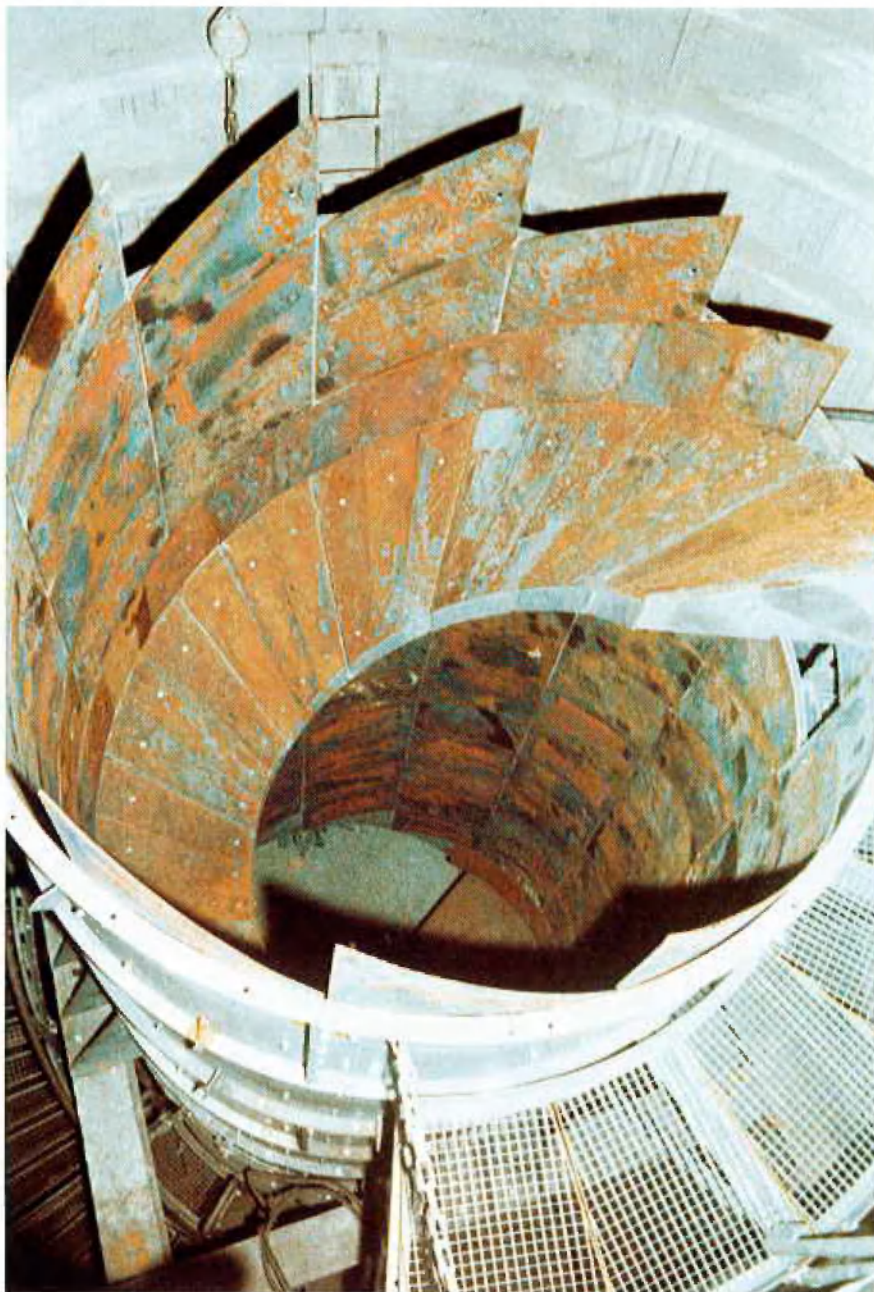
Stahl-Rohkohlenbunker mit eingebauter Stahlwendel
