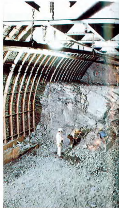
Phase II mit eingebauter Seilscheibenverlagerung
