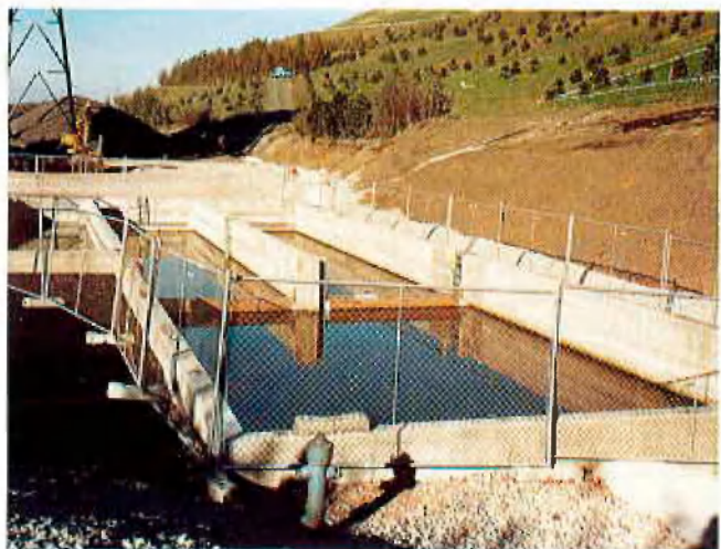
Landschaftsbauwerk Hoheward: Absetzbecken
