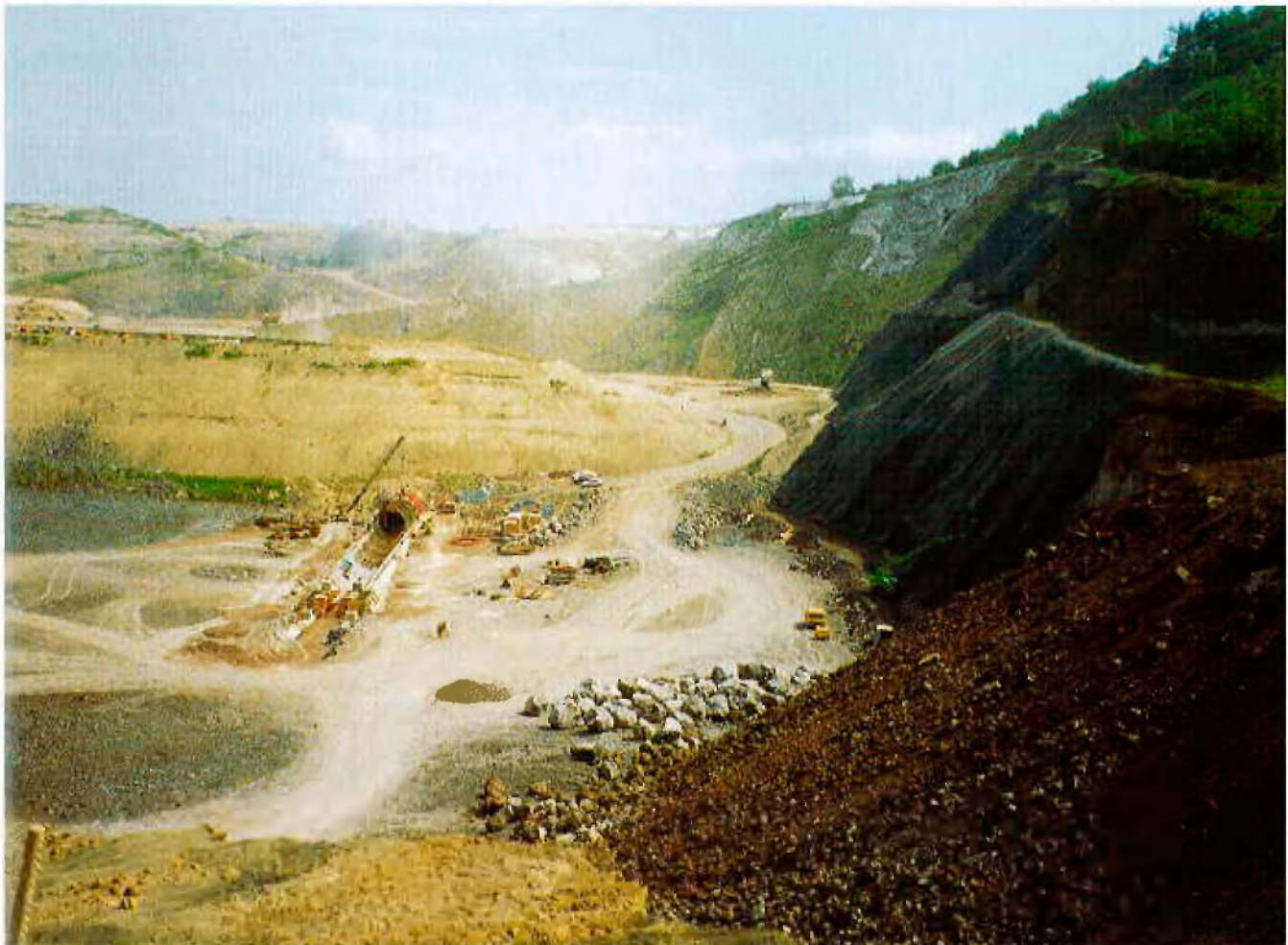
Teilansicht des Restloches, im Hintergrund der erste Müllpolder, rechts die teilweise fertiggestellte Böschungssicherung „Michelberg“, links der Freibautunnel
