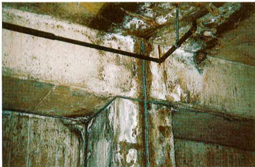
Korrosionsschäden vor der Sanierung
