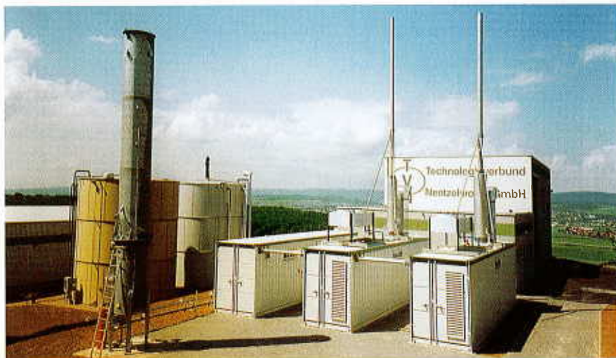
Blockheizkraftwerke für die Biogas- und Deponiegasverwertung
