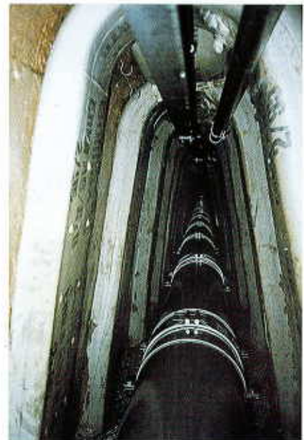
Stollen mit Trinkwasserleitung
