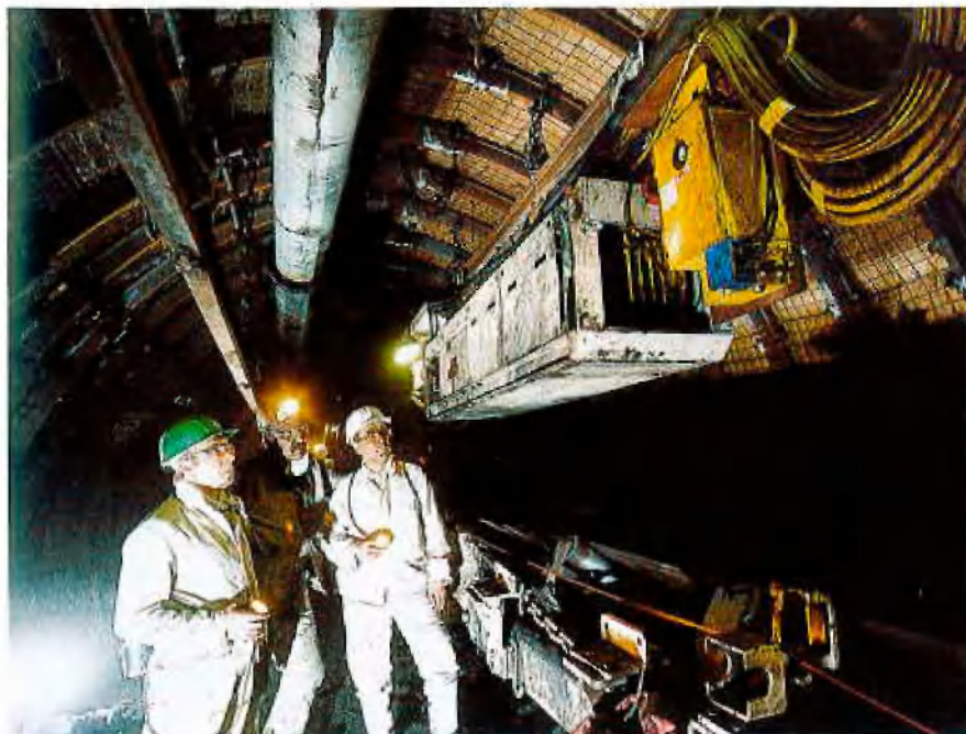
Hydraulikaggregat im Energiezug
