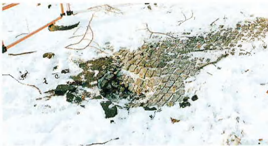
Tagebruch auf der Hauptstrasse in Bermsgrün
